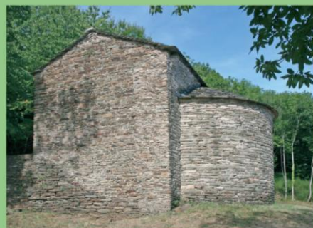
« Coup de sabre » de reprise bien visible.
